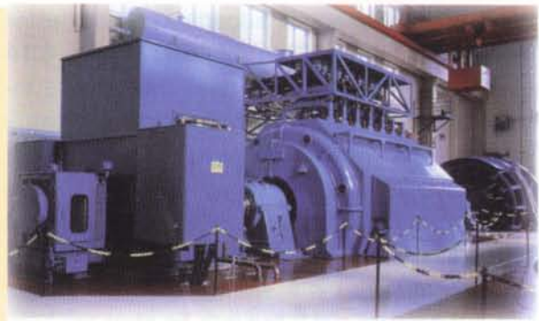
Figura 6.17. Alternador industrial de 300MW
